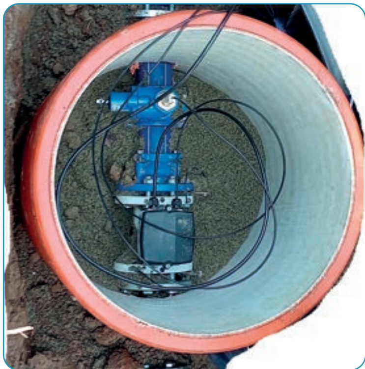
Zabudowany przepływomierz z rejestratorem ciśnienia oraz kompletem zasuw.
