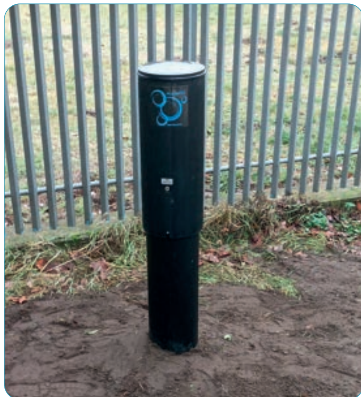
Punkt pomiarowy – słupek telemetryczny
