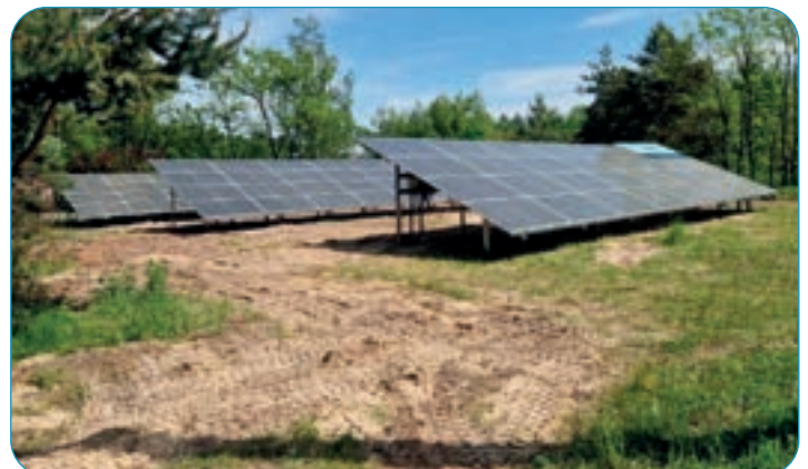
Farma na Stacji Uzdadniania Wody 2 Szarów – rok budowy 2023
